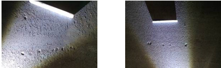
图 1 钢板表面凹坑
